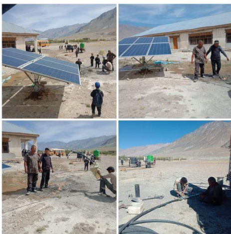
Figure 23 nouvelle pompe solaire
